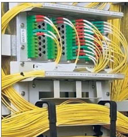
Glasfaserkabel der Telekom. Die Bundesregierung will den Bonner Konzernen unterstützen. Foto: lok/R. Haas
